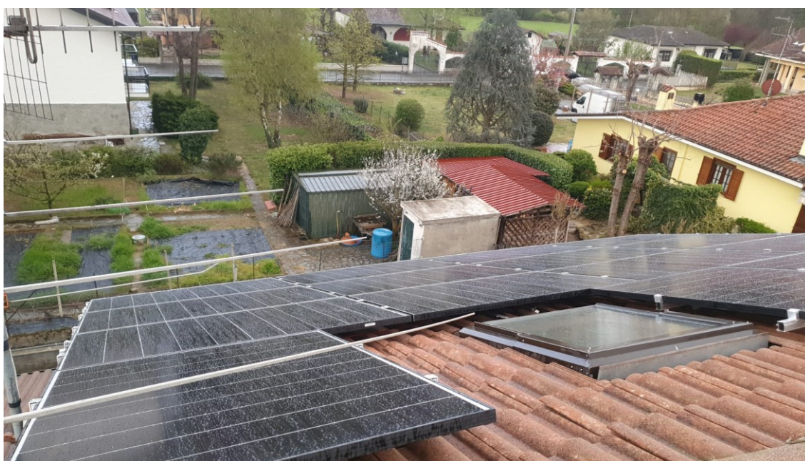
Foto 1. Impianto fotovoltaico terminato
