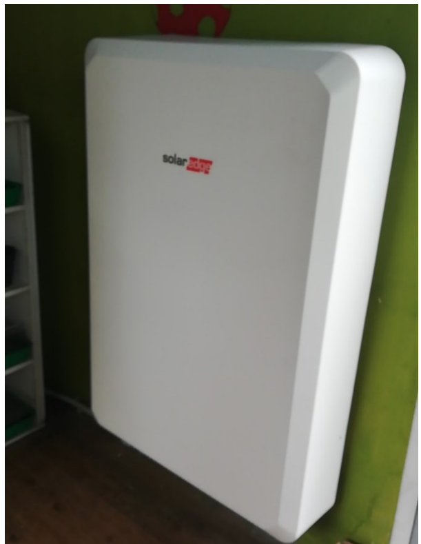
Foto 1-2.-3. Impianto fotovoltaico terminato, inverter, quadro elettrico e sistema di accumulo
