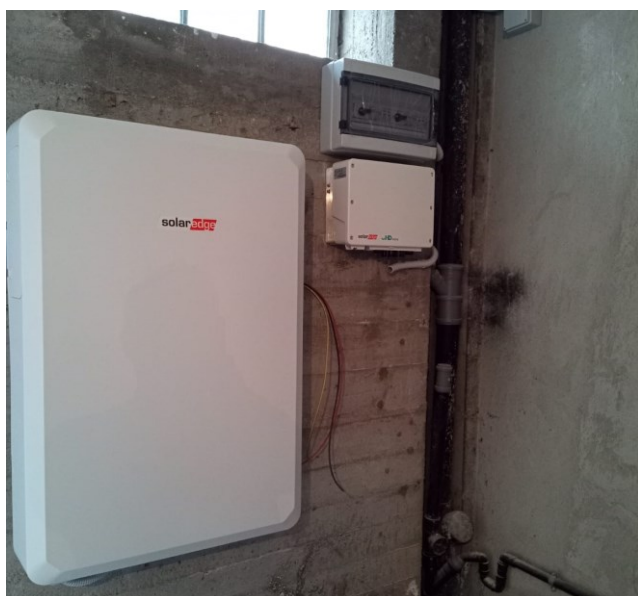
Foto 1. Impianto fotovoltaico terminato
