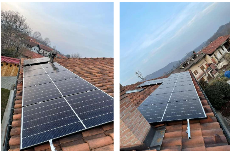
Foto 2-3. Impianto fotovoltaico terminato
